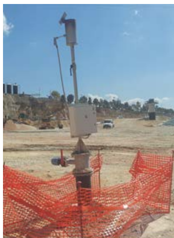
Impianto recupero energetico biogas (a sx) e torcia statica testa pozzo (a dx)
