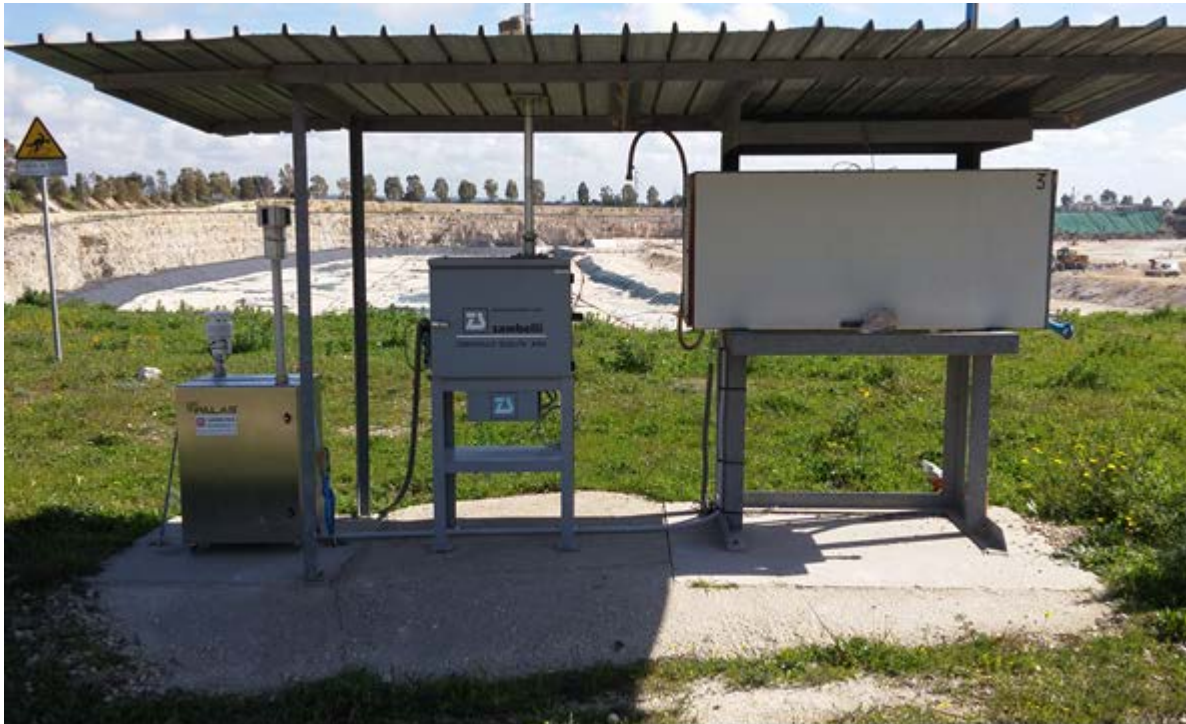
Centralina di monitoraggio aria n°3
