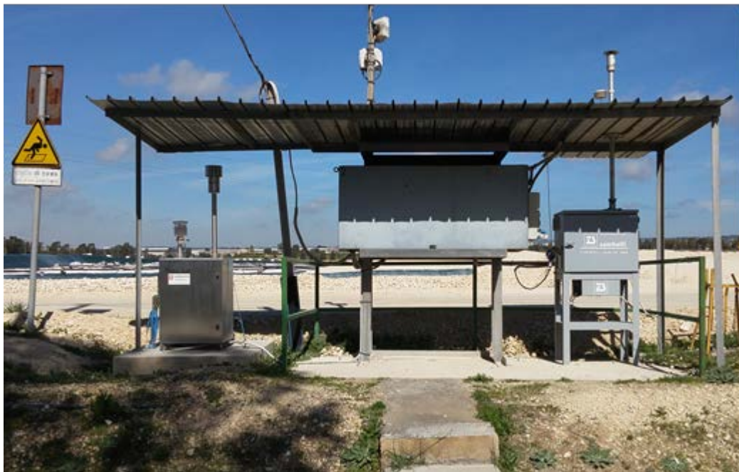
Centralina di monitoraggio aria n°2
